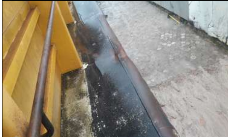
Figura 1.5 – Avarias na região do trincaiz com ondulações. Fonte: O Autor.
